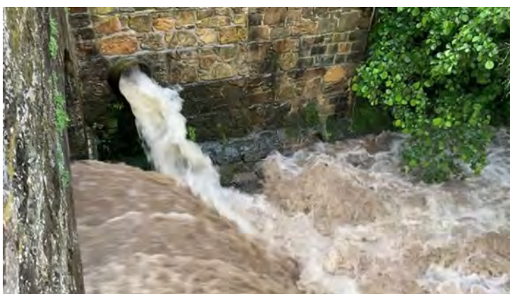
Fig. 39. Le débit du Ry de Jance renforcé par l'eau de la canalisation de la rue du Trou d'Herbois.
