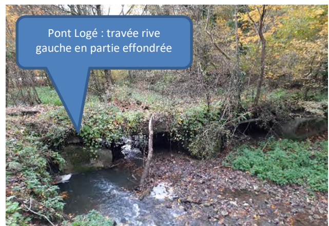
Fig. 48. État du Pont Logé en juillet 2021.
