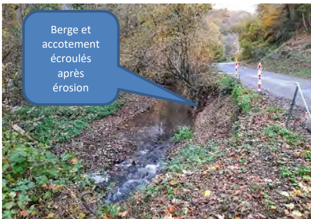
Fig. 47. Berge effondrée en amont du Pont Logé
