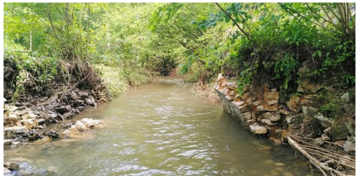
Fig. 46. Ce qu'il reste du pont après la crue de juillet 2021.
